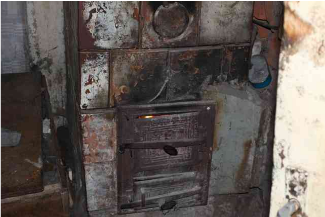
Auch dieser Ofen würde in Deutschland beim Schornsteinfeger durchfallen.
